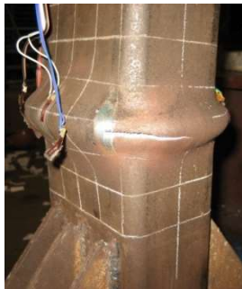
(d) Finally - rupture of steel tube
